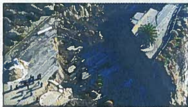
Paseo del Mar Landslide (2011)
